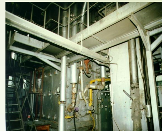
Vederea frontului cazanului pilot din cadrul UPB
